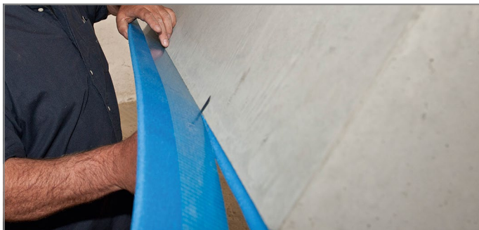
Abb. 111: Überstand von Tronsole® Typ B bündig abschneiden
