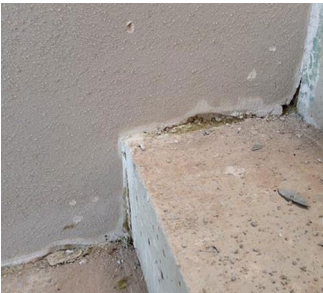
Abb. 4: Schallbrücke durch Folgegewerk
