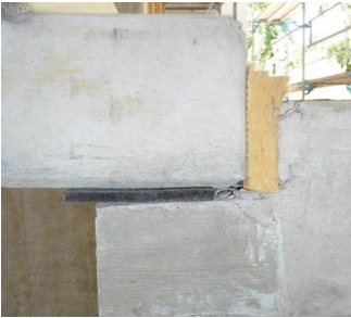
Abb. 2: Schallbrücke durch lückenhafte Baustellenslösungen
