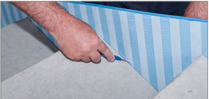
Abb. 136: Schutzfolie im Bereich der zu beklebenden Fläche einschneiden
